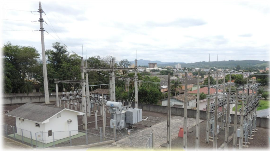
Imagem 02 – Subestação da Cooperativa Energética Cocal.
